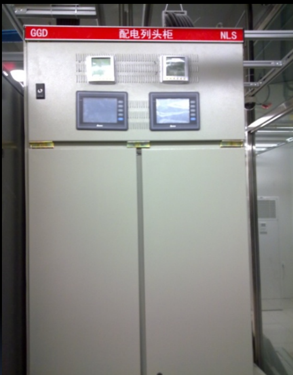
UPS输出配电柜前
